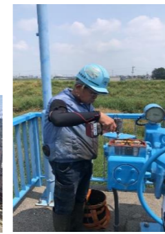
開閉装置点検
